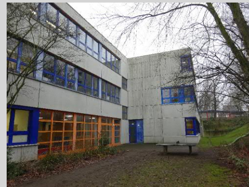
Zu sanierende Sichtbetonfassade aus den 1970er Jahren
